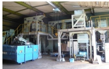
篩機及び袋詰め装置
